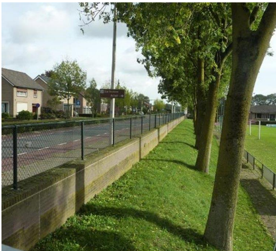
Figuur 2.2: Zicht op de huidige keermuur langs de Sint Janstraat
